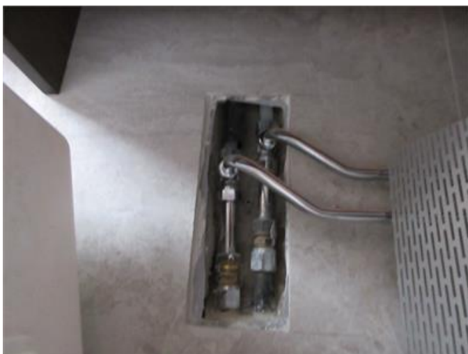
Inget tätskikt på vägg bakom vattenrör under tvättställskommod.
