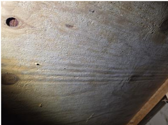
Mikrobiell påväxt på underlagstak.
