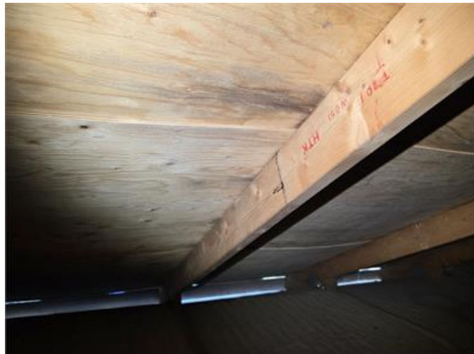
Fuktfläck på underlagstak.
