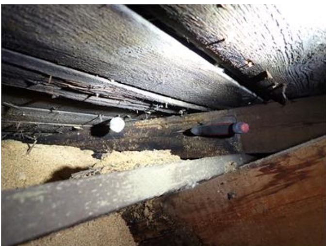
Rötskada i takstol/råspont vind.
