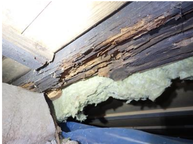
Exempel på rötskador i bärlina.
