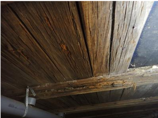
Exempel på rötskador i blindbotten samt bärlinor.
