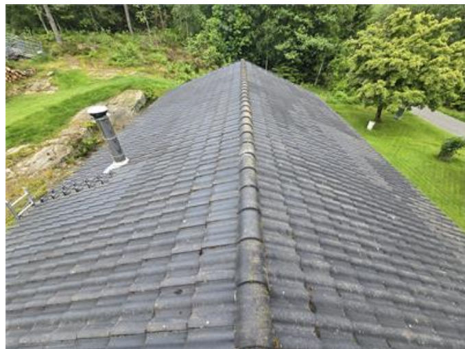
Tak: Översiktsbild, ytskikt något bristfälligt, mossa förekommer.
