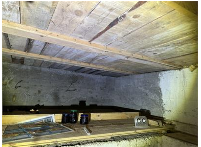
Mikrobiell påväxt på bjälklagets undersida i matkällare.
