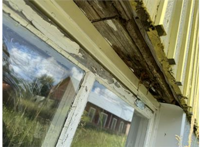
Rötskador i vägg över källarfönster.
