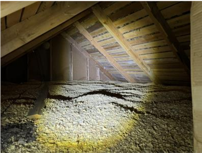
Mindre mikrobiell påväxt förekommer på underlagstak.
