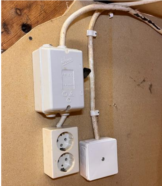
Sidan 10: Sidan 10: "- 3-fasuttag av metall finns." - Åtgärdat, bortkopplat.
