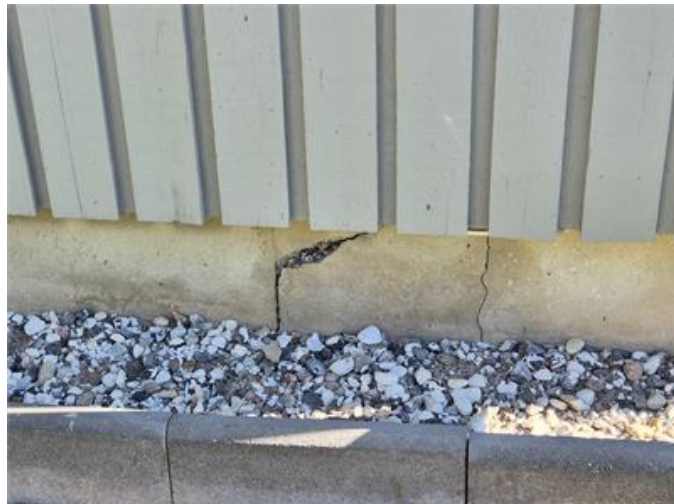
Spricka i sockeln.
