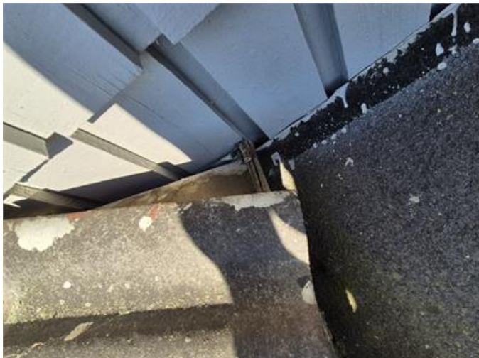
Rötskadad läkt vid entrétaket.
