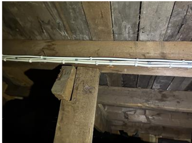
Sidovind 3: Missfärgningar finns på underlagsbrädor, bedömt äldre.
