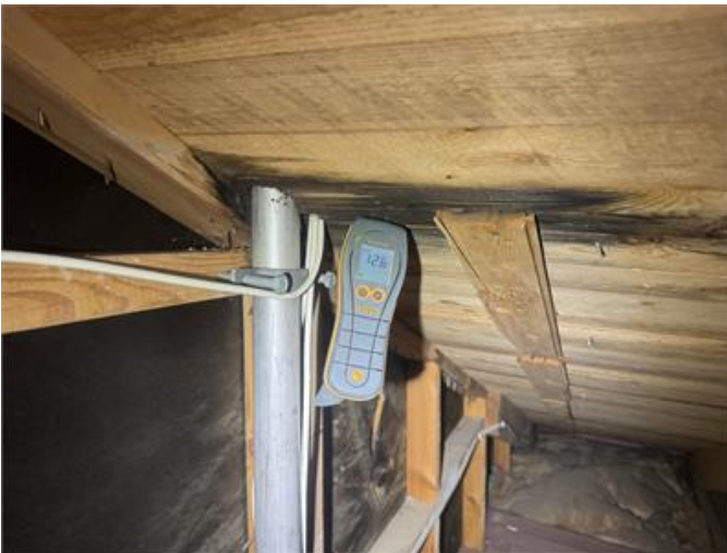
Fuktrelaterad missfärgning på garagets nockvind.
