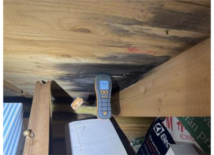
Äldre fuktrelaterad missfärgning på nockvindens underlagstak.
