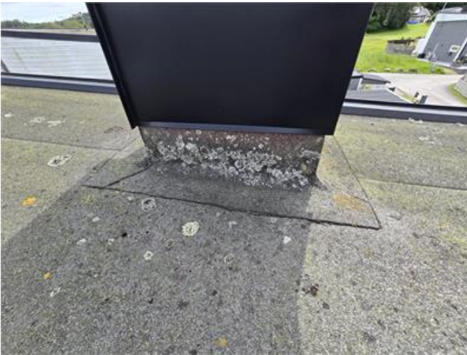
Tak: Mossa/lav har fått fäste, ålder på tak är okänd.
