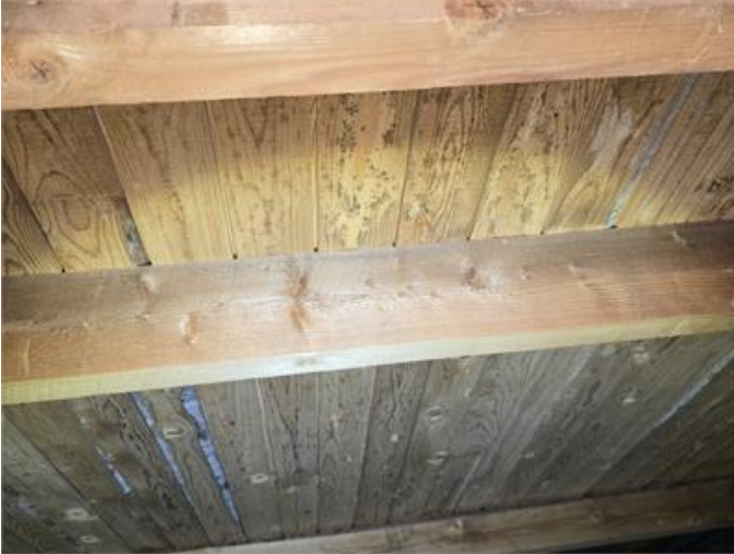
Nockvind: Ytlig mikrobiell påväxt på underlagstak.
