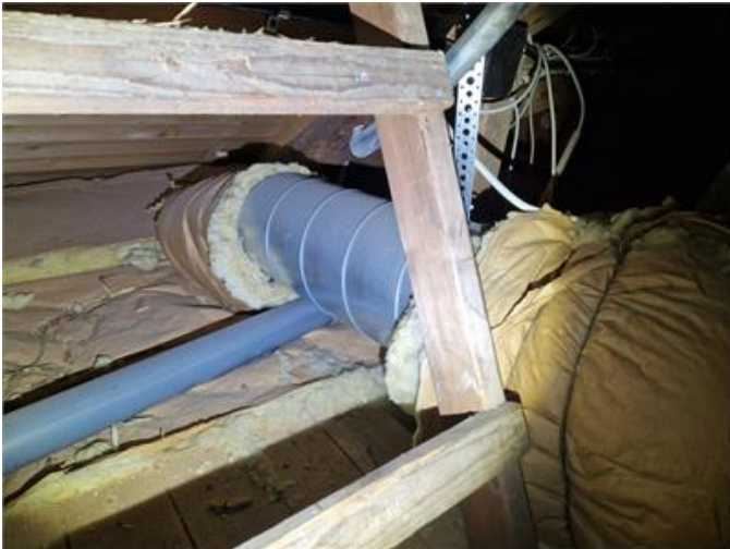
Vind: Oisolerad del på ventilationsrör noterades
