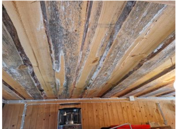
Garage: Mikrobiell påväxt förekommer i underlagstak.
