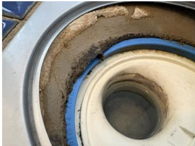
Bilden golvbrunn där tätskiktet är skadat/otätt.
