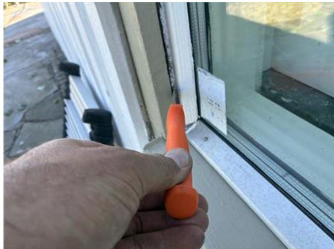
Fasad: Bilden visar otäthet mellan fönster och foder.
