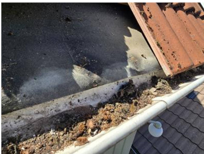
Tak: stickprovskontroll under pannor vid takfot, pannor ej infästa, fotplåt finns ej. Rännor fulla med skräp.
