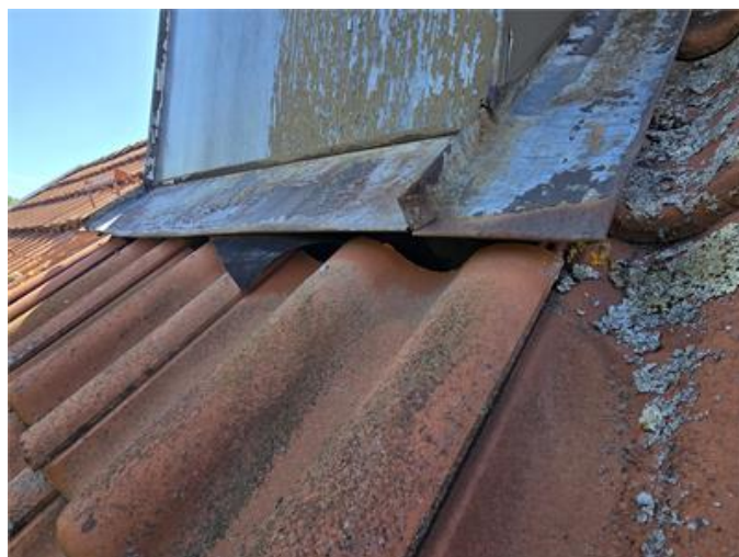
Tak: Plåtar på murstock är äldre och täcker bristfälligt över pannor.
