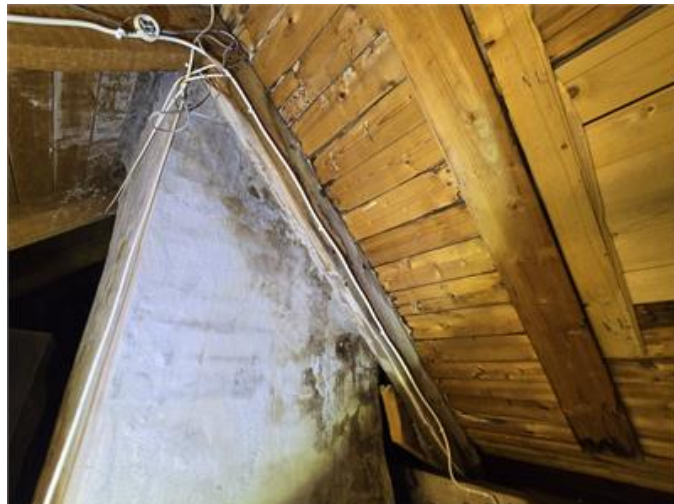
Nockvind: Fuktanvisningar/missfärgningar runt murstock.
