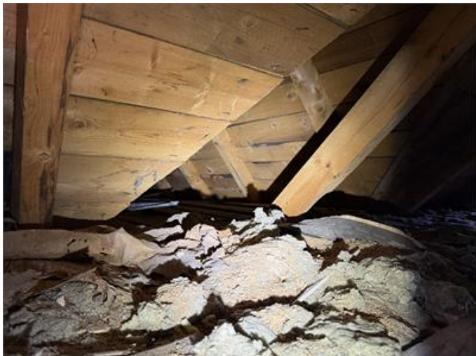
Översiktsbildnockvind, exempel missfärgning/fuktfäckar underlagstak
