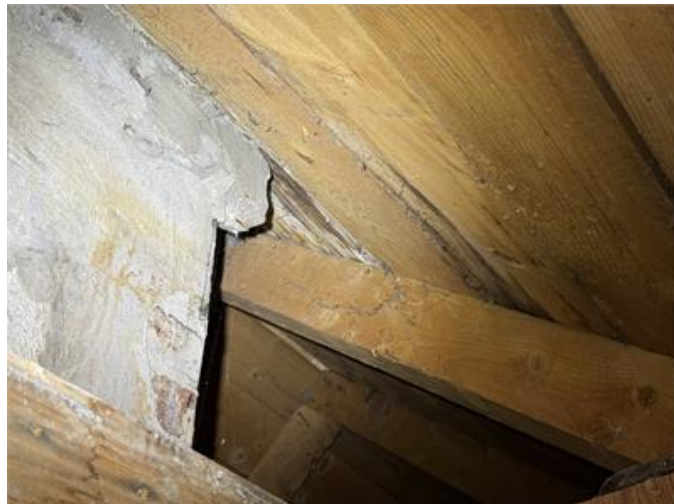
Exempel missfärgning/fuktfäckar underlagstak invid murstock
