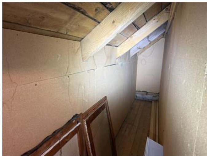
Exempel fuktfäckar/missfärgning vägg ena sidovinden
