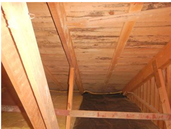
Mikrobiell påväxt på yttertaketets insida över tvättstuga
