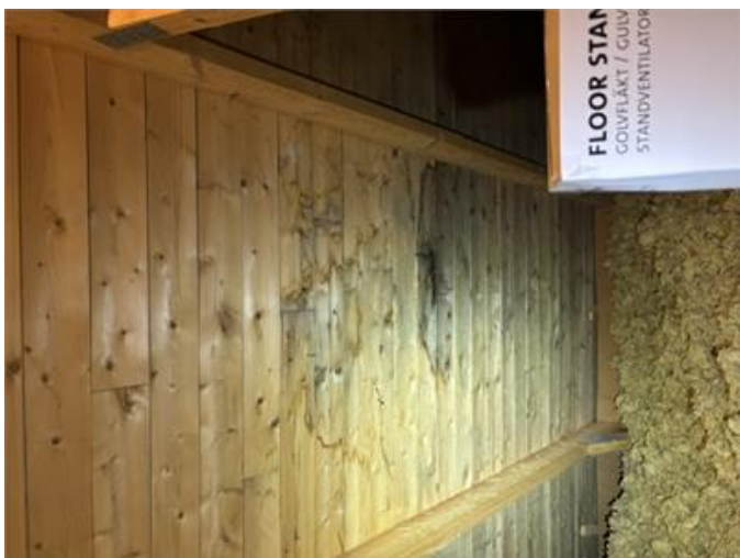
Missfärgningar pånockvindens underlagstak.
