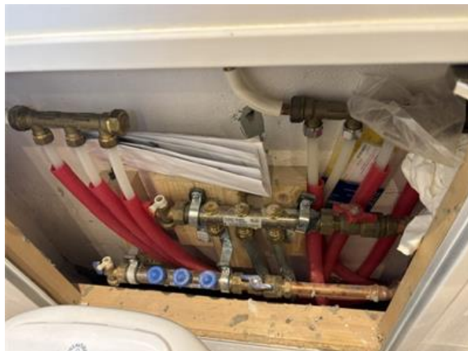
Va-installationer ej fuktsäkert installerade.
