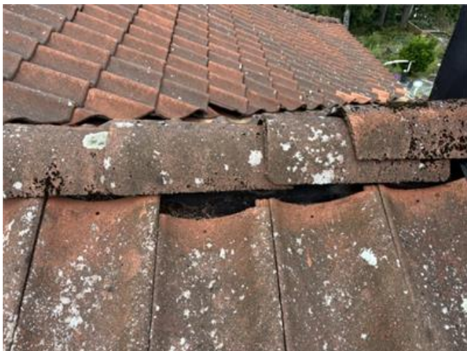
Övre takpannor som glidit ner.
