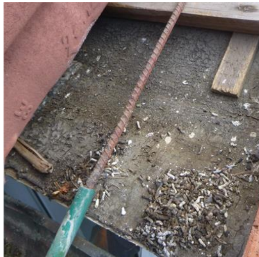
Underlagstaket ej bytt vid takbytet
