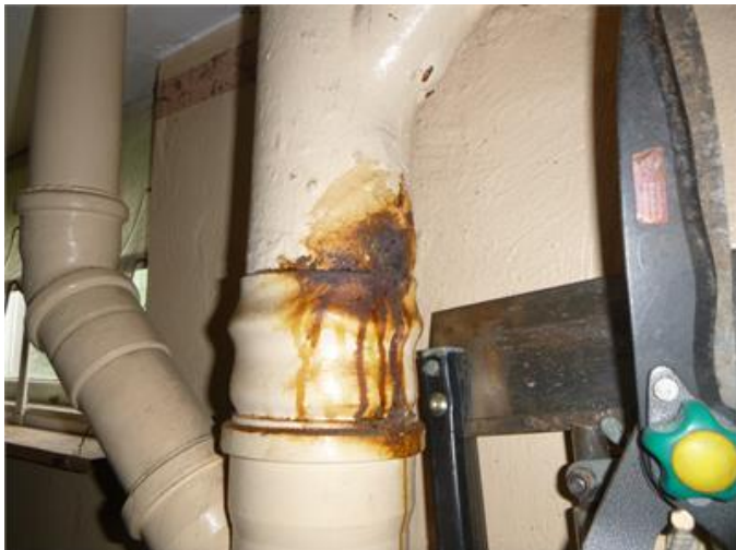
Korrosion i avloppsstam
