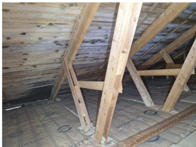
Nockvind, mikrobiell påväxt i underlagstaket nordost.
