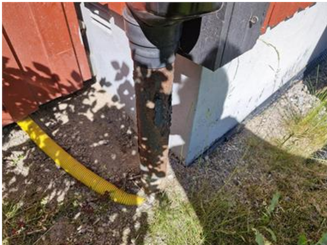
Mark, oklart om dränering är utförd baksidan vid uterum och altan, äldre dagvattenrör av gjutjärn.
