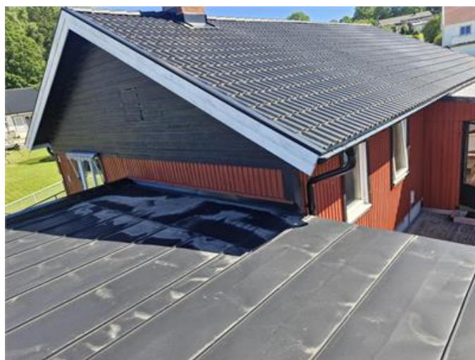
Tak, garagetak har lågpunkts där vatten blir stående.
