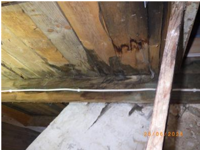
Missfärgning av underlagstak inockvind.
