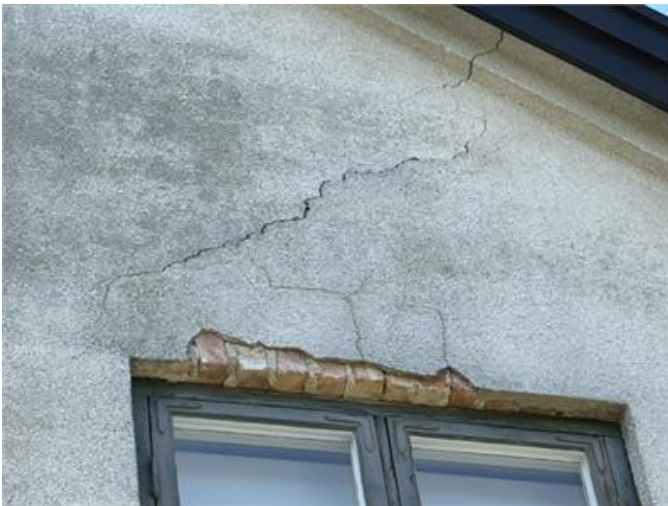
Det förekommer putsbom och sprickor i fasaden runt om huset. Putslagningar samt lagningar av tegelfog/sprickor kan förväntas löpande behövas utföras i äldre fasader. Enstaka spricka har åtgärdsbehov.
