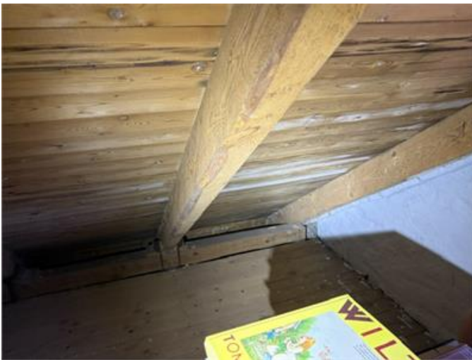
Mikrobiell påväxt förekommer i begränsad omfattning, vilket bör kontrolleras regelbundet så att skadorna inte förvärras.
