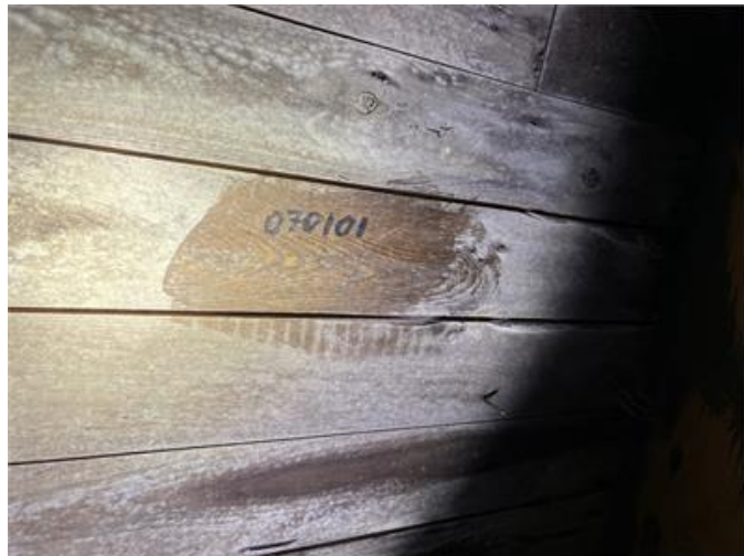
Mikrobiell påväxt i underlagstak på vind
