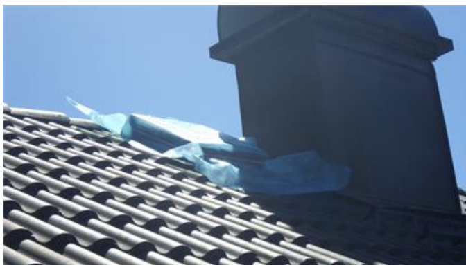
Takfönster täckt med plastfolie
