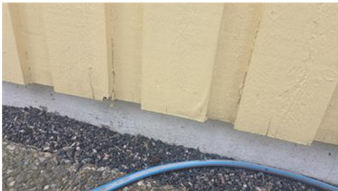
Exempelbild, rötskadad fasad.
