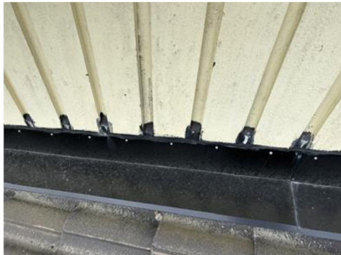
Bilden visar exempel på där otätheter/brister förekommer där garagetaket möter fasaden.
