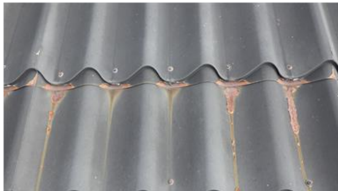
Rostig plåt på hustaket
