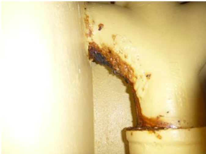
Korrosion i avloppsstam av gjutjärn
