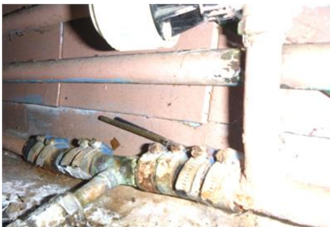
Tillfälligt lagat radiatorrör i tvättstugan
