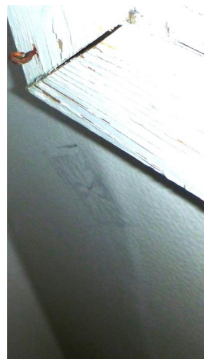
Otättheter kring fönstret i duschen på entréplanet med förändring i väggen
