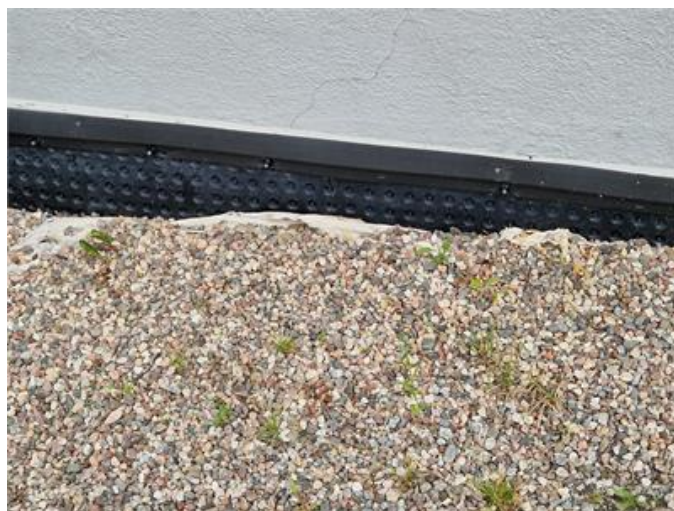
Sockel: Utvändigt fuktskydd synligt ovan mark.
