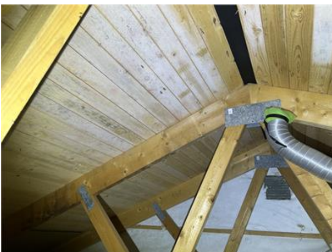
Nockvind: Mikrobiell påväxt noteras på underlagstaket.
