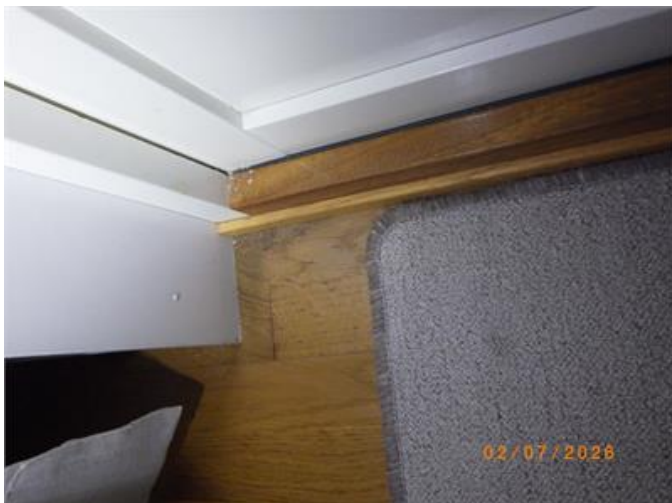
Missfärgning golv innanför balkongdörr.
