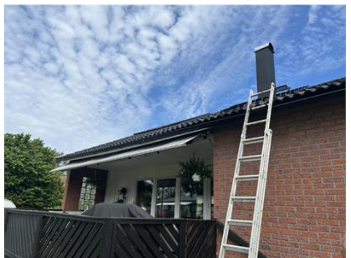
Tak: Svaka på taket noteras främst ovan altan. Kontakta fackman för kontroll.
