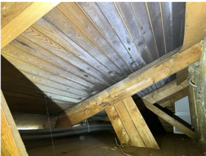
Sidovindar: Mikrobiell påväxt på underlagstaket.
