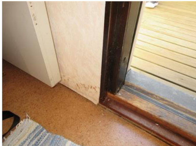
Fuktskada i yttervägg i entréhall
