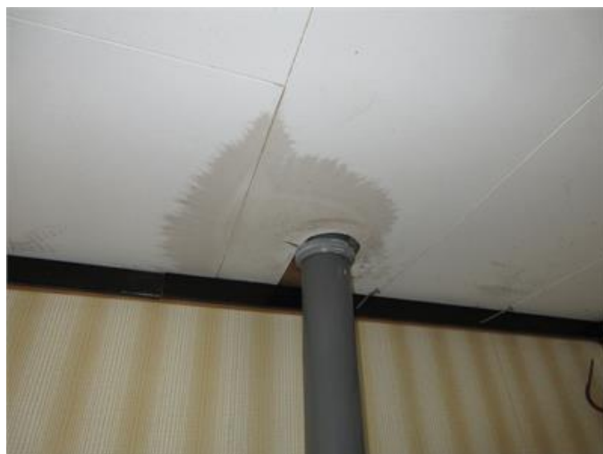
Missfärgning i tak runt takbrunn
