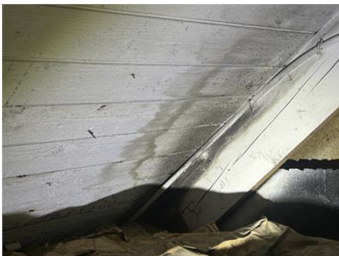
Nockvind: Fuktgenomslag noteras på flera ställen.
