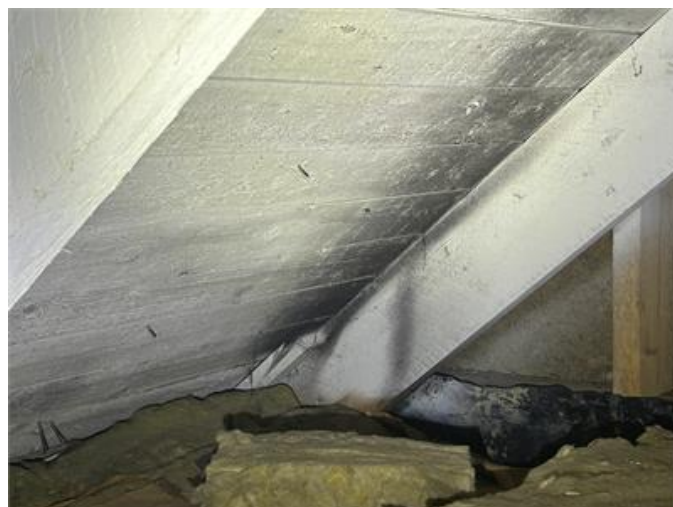
Nockvind: Mikrobiell påväxt noteras på underlagstak.
