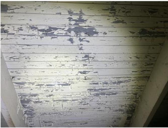
Nockvind: Rikligt med färgsläpp förekommer.
