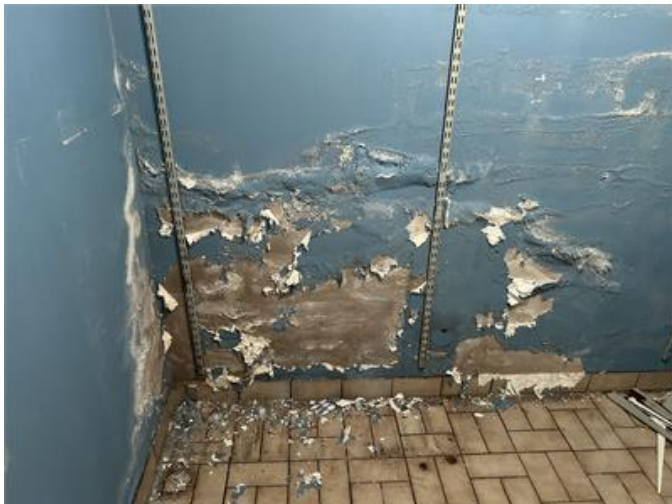
Källare: Fuktgenomslag, färgsläpp och mineralutfällningar förekommer på flera ställen.
