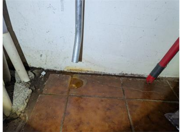
Uppvikt tätskikt saknas vid spillvattenrör i tvättstuga/pannrum.
