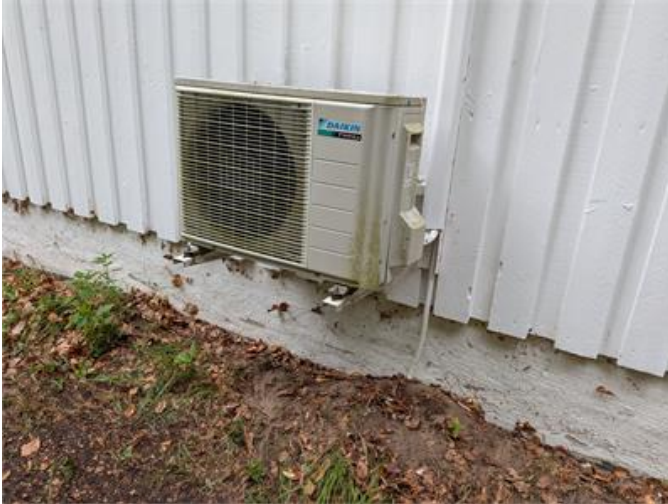
Luftvärmepump saknar vattenavledning
