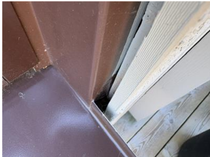
Bilden visar exempel på otätheter/brister vid/med plåtdetalj.
