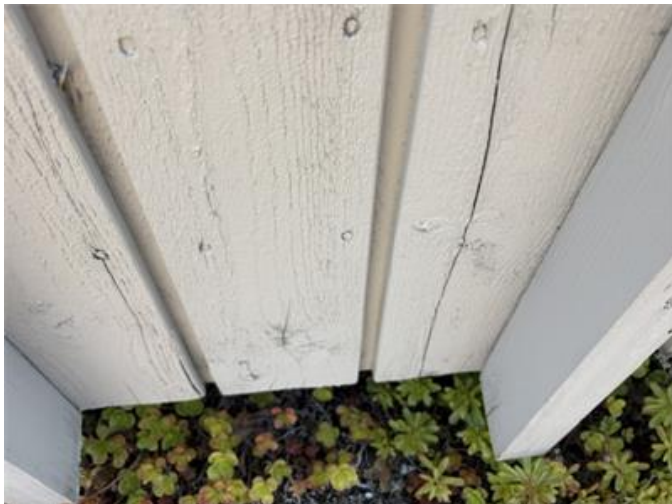
Bilden visar exempel på torrsprickor i fasadpanel.
