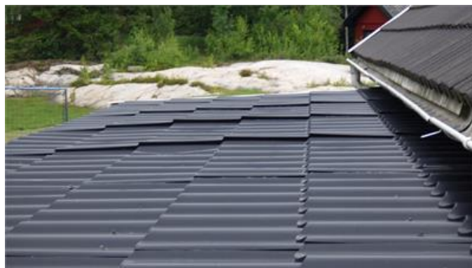
Bucklig/otät takplåt över farstukvisten
