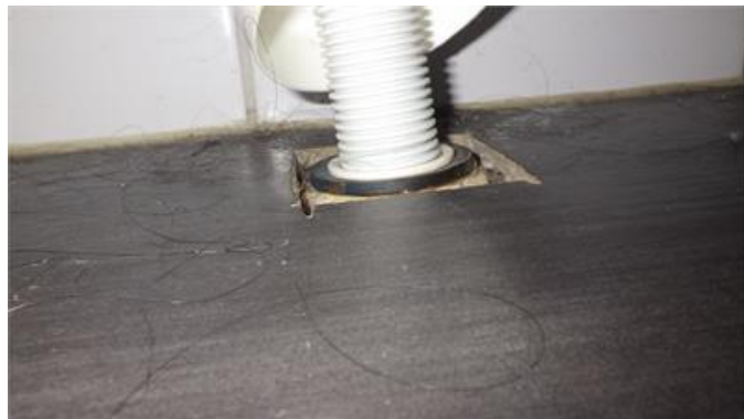
Handfatsavloppets stös som inte är uppdragen över golv
