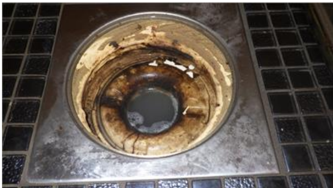
Golvbrunn utan synlig brunnsmanschett
