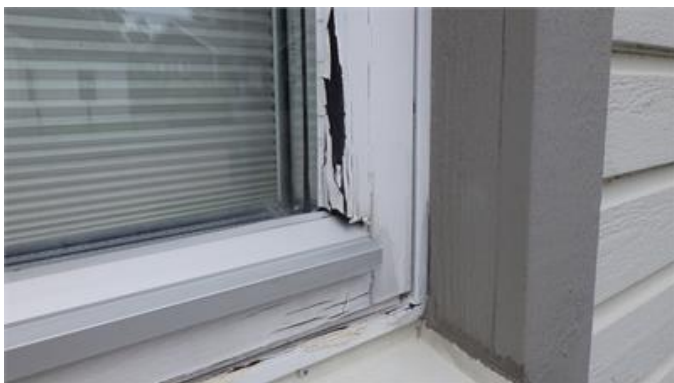
Fönster med målning/underhållsbehov
