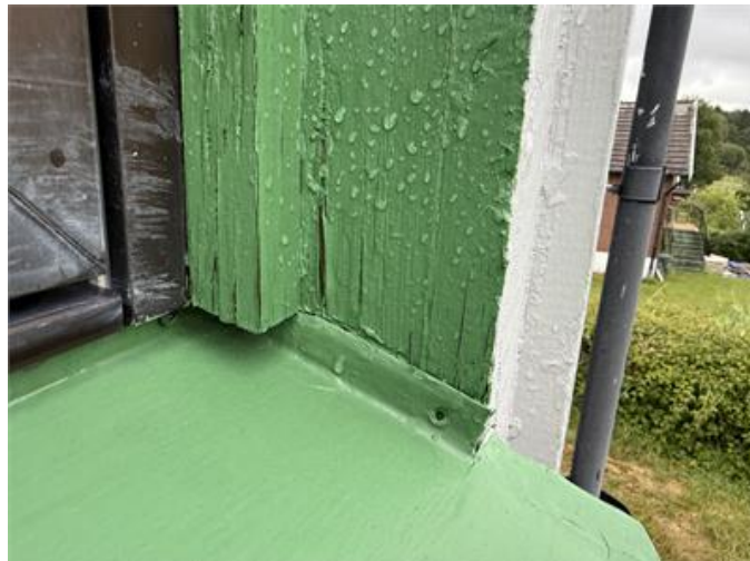
Exempel bristfälliga/otäta plåtdetaljer invid fönster samt mindre målning/underhållsbehov trädetaljer
