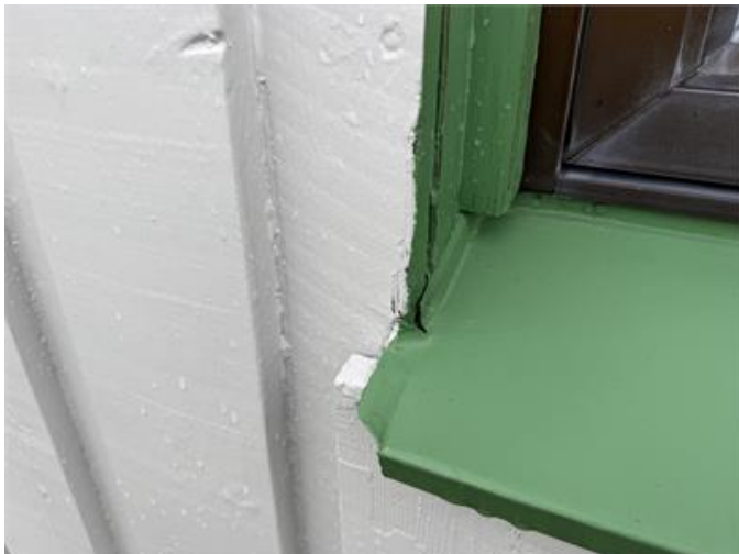
Exempel bristfälliga/otäta plåtdetaljer invid fönster
