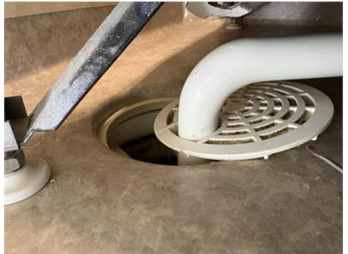
Klämring golvbrunn under duschkabin är lös och rekommenderas att bytas ut.
