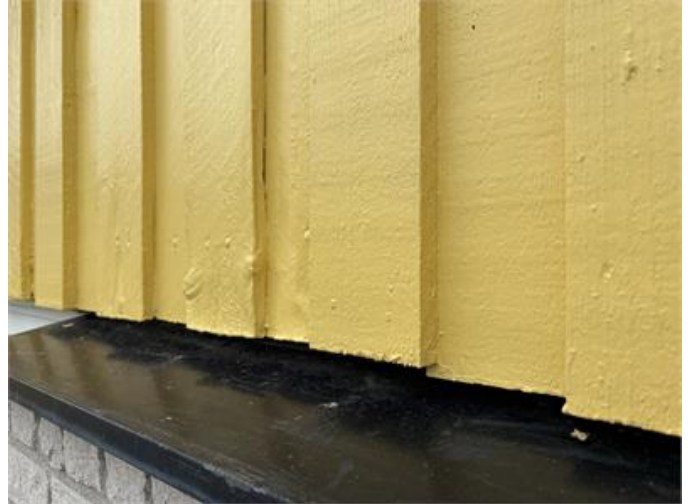
Gavelpanel har rötskador(övermålat) främst ändträ.
