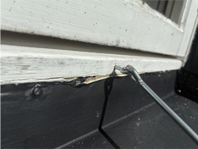
Tak (takkupor): Mindre otätheter noterades där plåtar ansluter till karmens understycke
