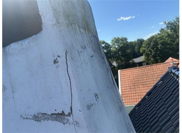
Skorsten: Skorsten har underhåll och målningsbehov.
