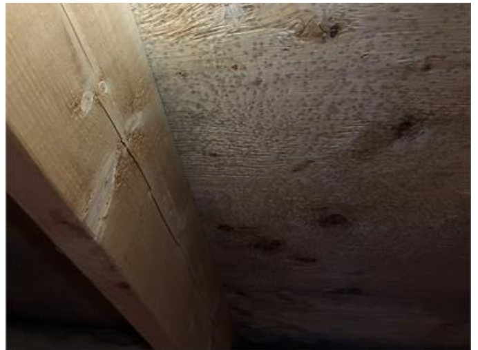
Nockvind: Missfärgningar/mikrobiell påväxt noterades på underlagstaket.
