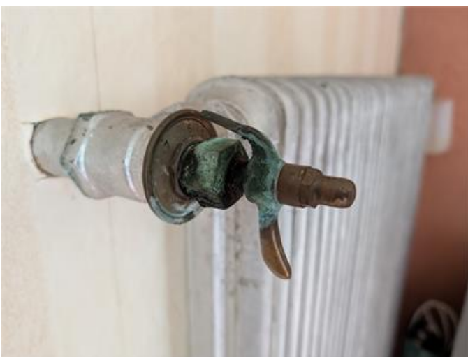
Kraftigt ärgad koppling. Samtliga element till vattenburen värme visar spår av äldre och/eller pågående läckage.
