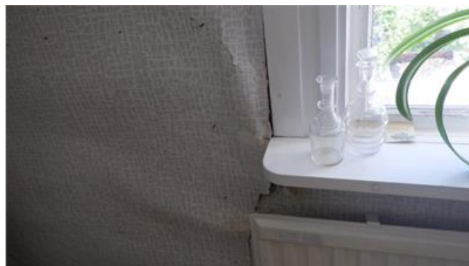
Invändigt ytskikt som släppt från underlaget.
