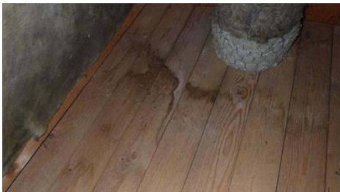
Fuktfläck på golvet i sidovind
