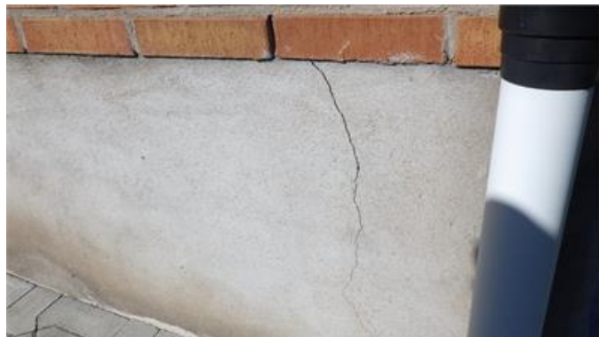
Spricka i sockeln
