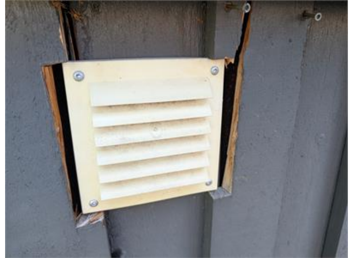
Otäteter runt friskluftsventil.
