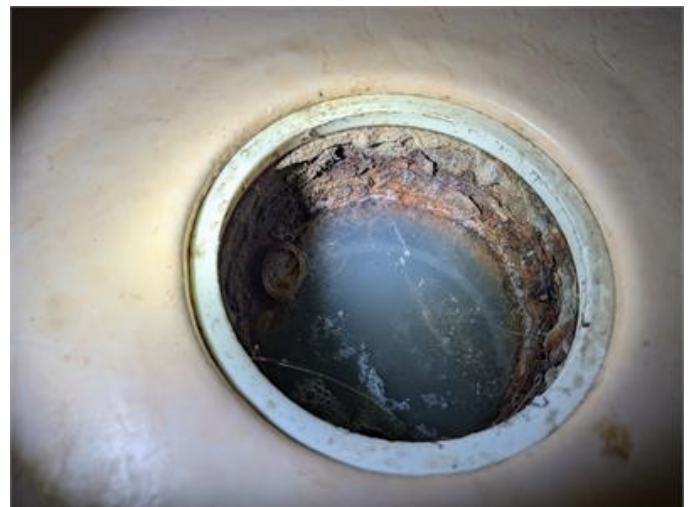
Rostig gjutsjärnsbrunn. Rostiga stammar och brunnar av gjutjärn ökar risk för läckage.
