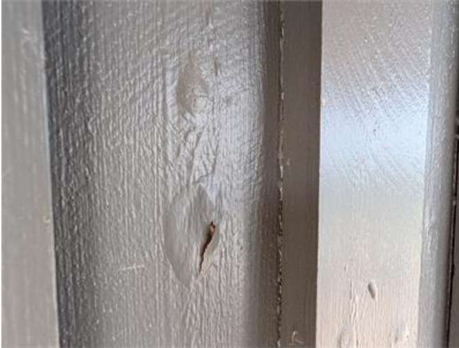
Äldre fasad som ej byttes vid renovering har blåsbildning. Delar har underhållsbehov alternativt byte.
