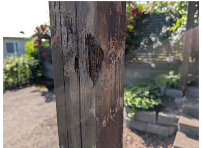
Bärande stolpar vid entré har fuktskador.
