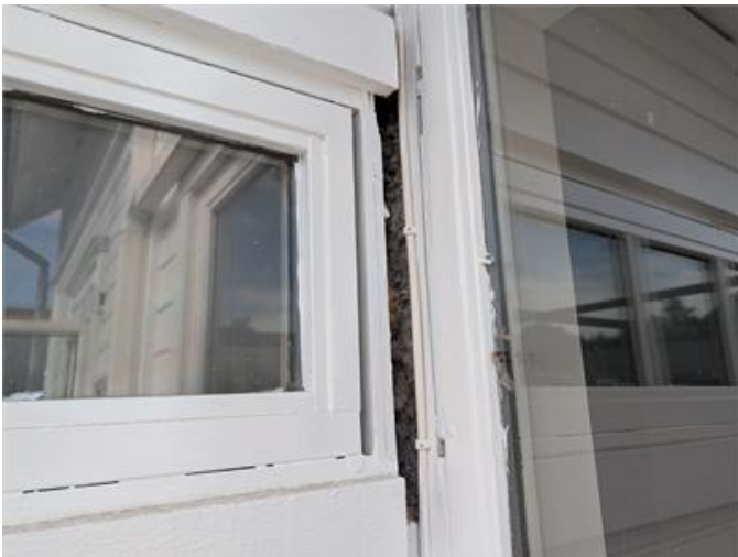
Otätthet i fasad vid fönster, vilken bör åtgärdas.
