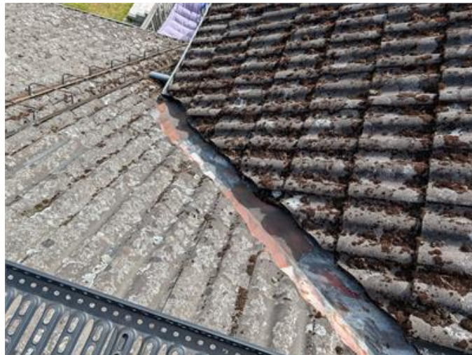
Exempelbild på tak med rostiga plåtar i vinkelränna samt lös panna.
