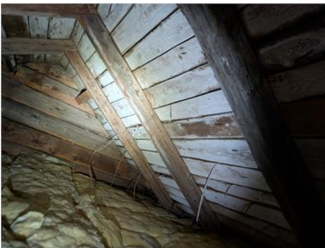
Mikrobiell påväxt på vind.
