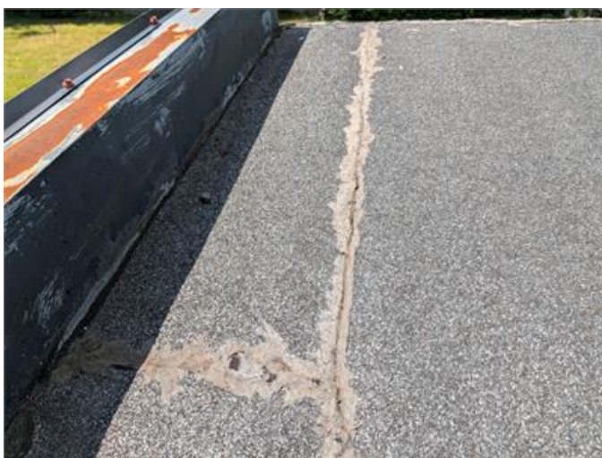
Garagetak med tätning som bör hållas under uppsikt alternativt åtgärdas.
