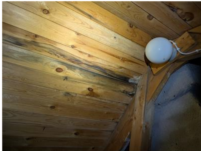
Spår av fuktinträngning på underlagstak.
