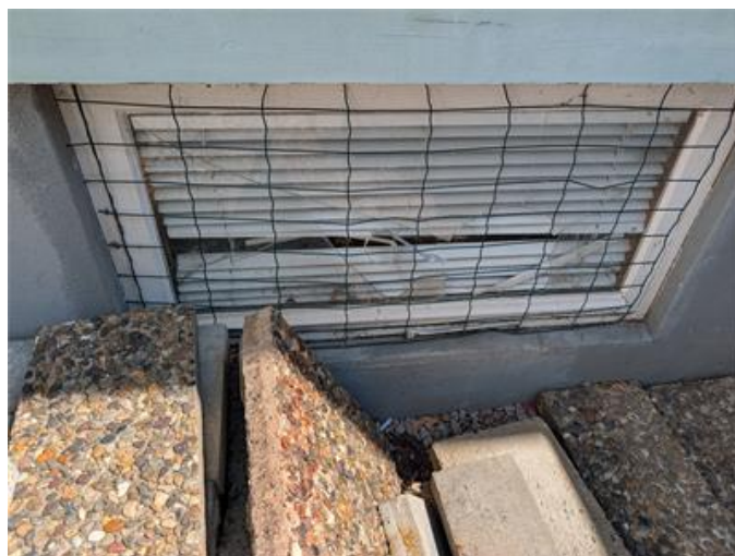
Trasig glasruta utan fönsterbleck.
