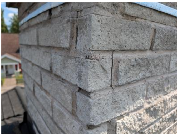
Sprickor i skorsten.
