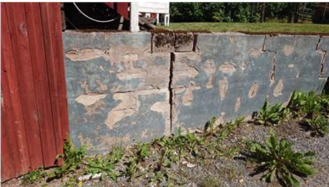
Utvändiga stödmurar är spruckna och utsatta för sättningar.
