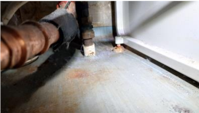
Värmepannan har delvis sjunkit ned i golvet innebärande risk att tätskiktet skadas.
