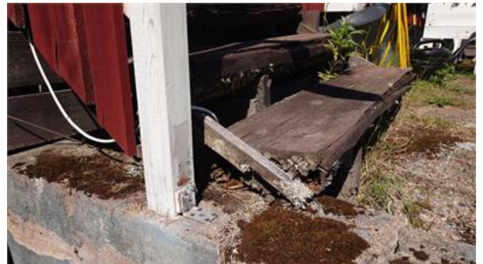
Entrétrappor, mm har ett renoveringsbehov då dessa rötskadats.
