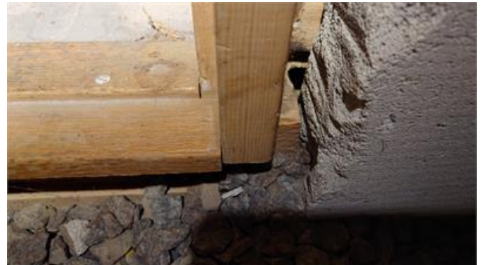
Hårdgjord golvyta saknas i matkällaren och träkonstruktioner ligger an mot gruset innebärande ökad risk för fuktpåverkan.
