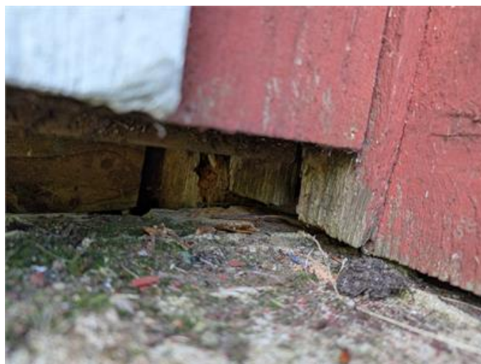
Fuktskadat material vid motgjuten trapp vid groventré.
