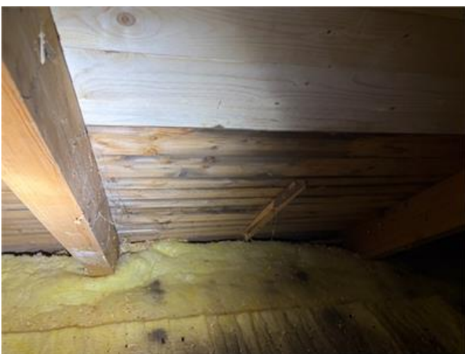
Lokala äldre missfärgningar förekommer som bedöms uppkommit innan taket renoverades.
