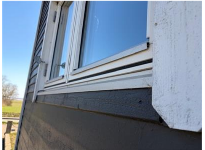
Några fönsterbleck är bristfälligt monterade (inte tillräckligt utdragna i framkant)
