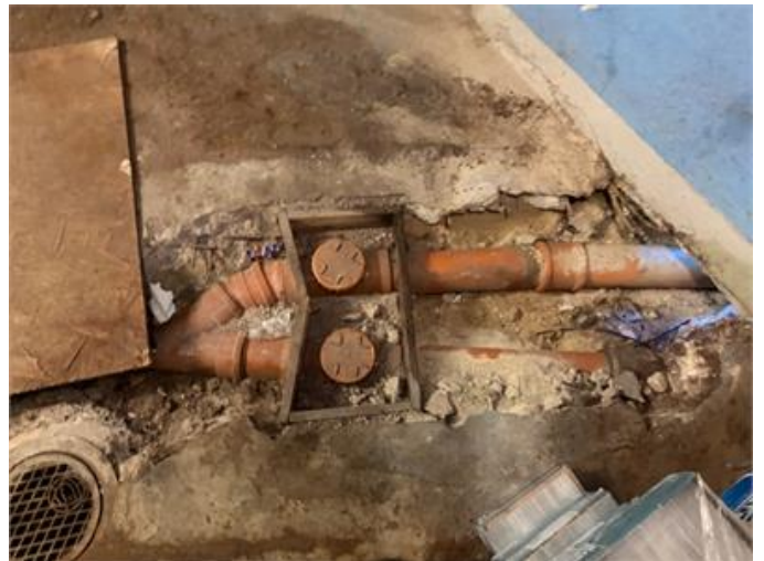
Betongplattan är inte återställd efter att stopp i avloppet åtgärdades.
