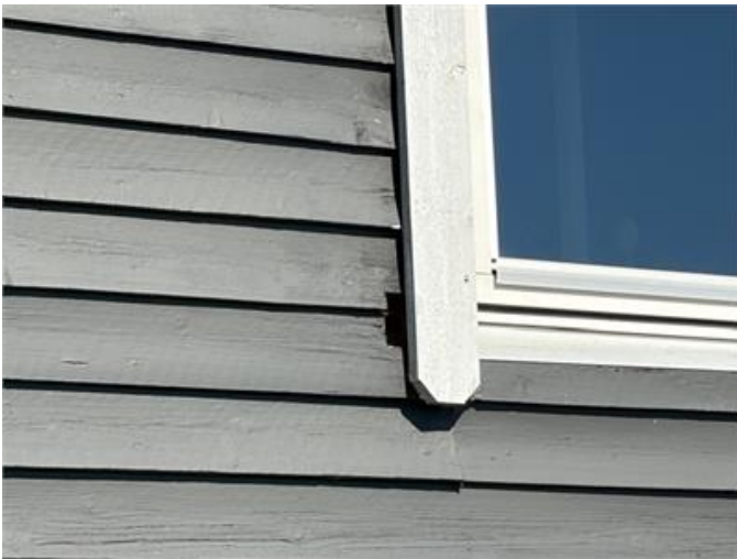
Mellan panel och foder till fönster övreplan noterades otätheter som bör åtgärdas (se bild)
