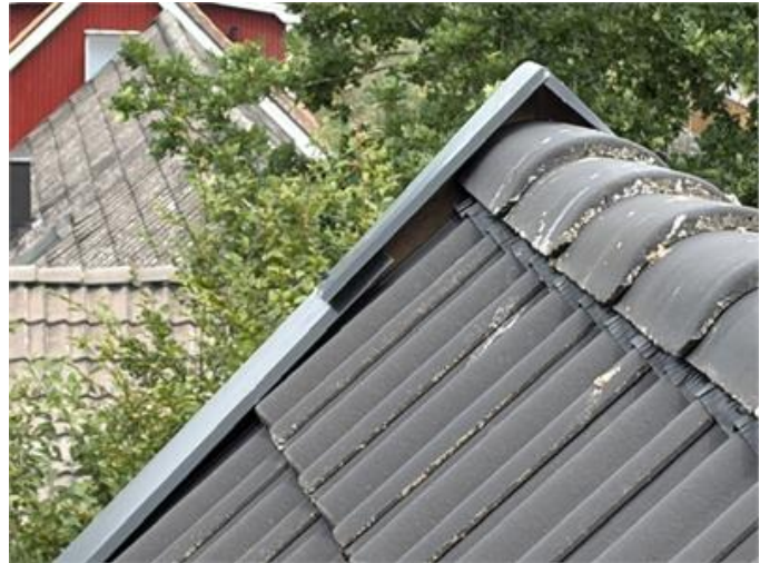
Delar av vindskivebeslag täcker något bristfälligt över takpannorna
