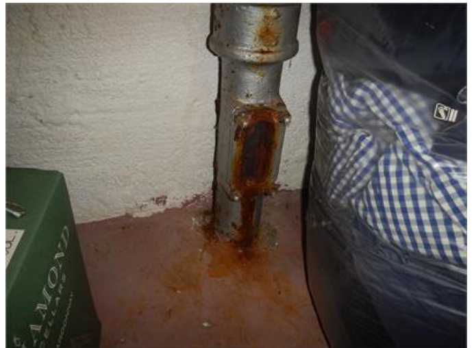
Rostigt avloppsrör / renslucka i källaren.
