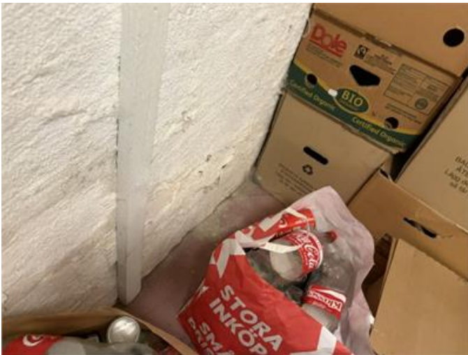
Fuktgenomslag på källarytterväggar.
